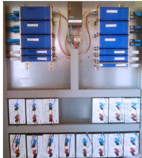
Anlagenschrank mit Messmodulen von imc
