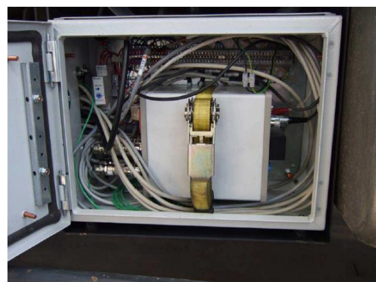
Abb. 3: Die eingebaute Messbox
